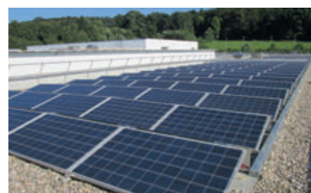
DEPUIS 2013, NOTRE TOIT EST ÉQUIPÉ DE PANNEAUX SOLAIRES POUR AINSI FOURNIR DE L'ÉLECTRICITÉ DE MANIÈRE ÉCOLOGIQUE
